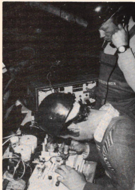
Afb. 8. Voor het lassen van glasvezels ontwikkelde AEG-Telefunken een techniek, die ook onder moeilijke montagecondities kan worden gebruikt. Op de foto ziet men het lastoestel in gebruik in een kabelschacht ergens op het experimentele traject in Berlijn. De vezels worden met behulp van een lichtboog aan elkaar gelast. De zo gemaakte verbinding is dempingsarm (0,2 dB demping) en heeft ongeveer de zelfde mechanische trekvastheid als de vezel zelf.
